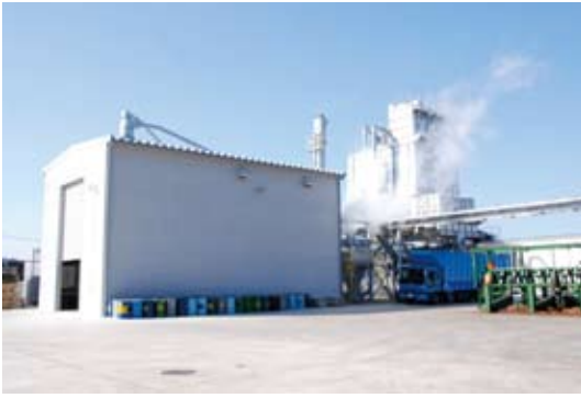
木屑吹きボイラーと乾燥設備
